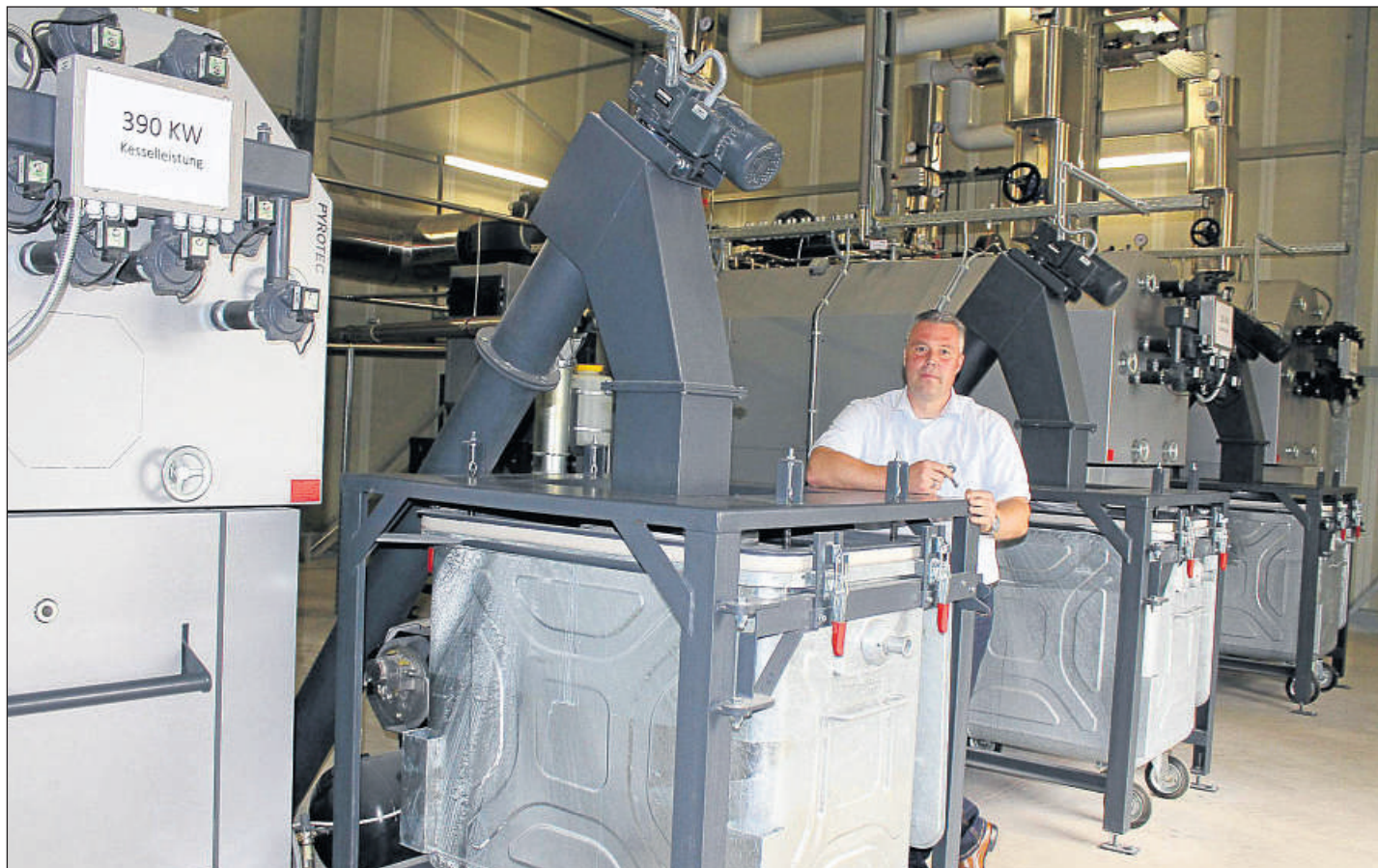
Das Pellet-Heizwerk mit seinen mächtigen Öfen: Sie sind unterschiedlich groß und werden nach Bedarf eingeschaltet, wenn bei extremer Witterung die Abwärme der Blockheizkraftwerke nicht ausreicht. Marco Ohme ist der Projektleiter bei Viessmann. Fotos (2): Hoffmann
